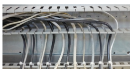
TRAVERSINI ANCORAGGIO CAVI
