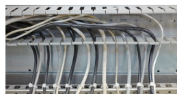
TRAVERSINI ANCORAGGIO CAVI
