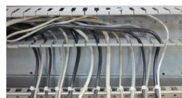
TRAVERSINI ANCORAGGIO CAVI
